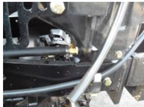
Vypouštěcí ventil nádrže na vodu
