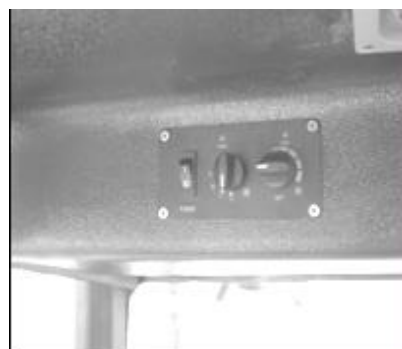
Obr. 3-44 Ovládací panel HVAC
